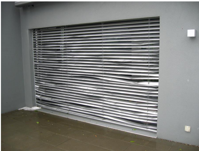
Illustration 2 : Les stores peuvent être endommagés même lors de petits orages de grêle. Ils devraient donc être relevés avant l'arrivée d'intempéries.
